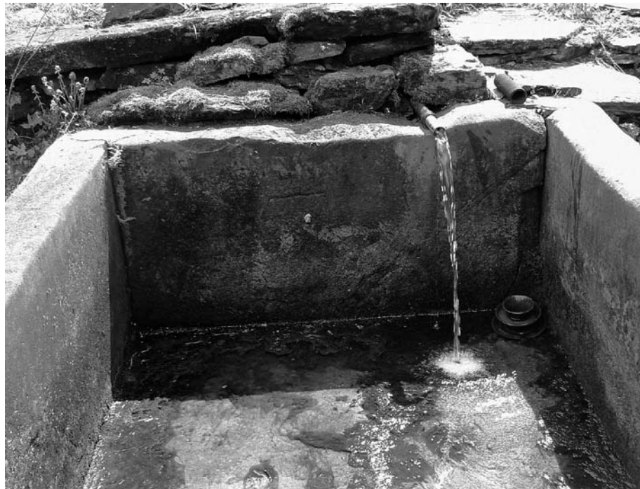
Jímka na vodu v Alojzově
